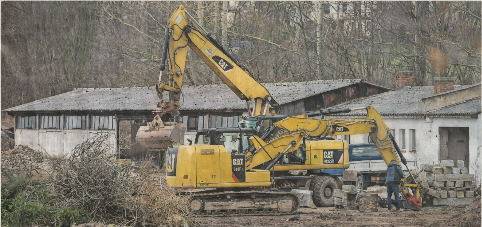
Bagger nagen sich durch Erdreich und Gebäude: In Bannewitz verschwindet derzeit eine frühere Rinderstallanlage aus dem Ortsbild.
